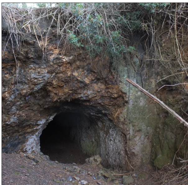
Entrada a la mina 15, en la qual es poden produir desprendiments a l'entrada si no es consolida la llinda.
