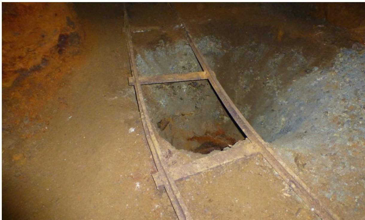
Restes dels rails que serviren per extraure el mineral situats en una galeria on s'accedeix per un dels pous de la Mina Gran. La difícil localització d'aquest element no hauria d'impedir que es prenguessin les mesures per retirar-los, restaurar-los i conservar-los com un element patrimonial valuós.
